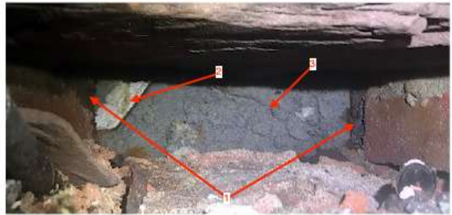
Bild 6 aus 2. Nachtrag: Detail Bild 5, 1 = Verrostete Reste der alten Tragkonstruktion des Turmes, 2 = mit Aufbau der neuen Tragkonstruktion eingebaute Aussteifung aus Edelstahl, 3 = Verfüllmaterial des Uhrenturmkerns, augenscheinlich vermutlich Zementmörtel ohne gröberes Stütz Korn.
